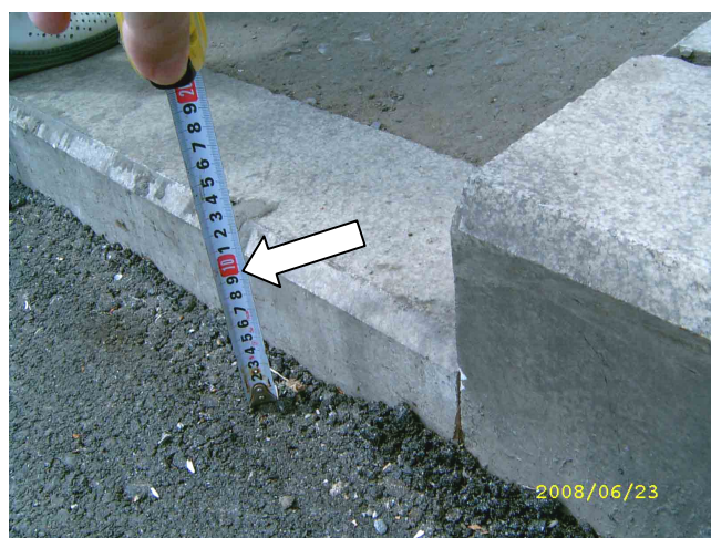
Рисунок 3.3. Перепад высот на тротуаре по ул. Красный Путь почти 10 см, г. Омск, 2008 г.
