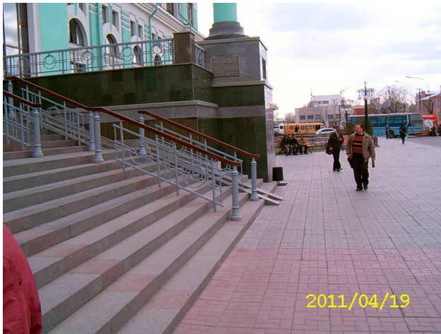
Рисунок 3.16. На крыльце установлены ненормативные пандусы
